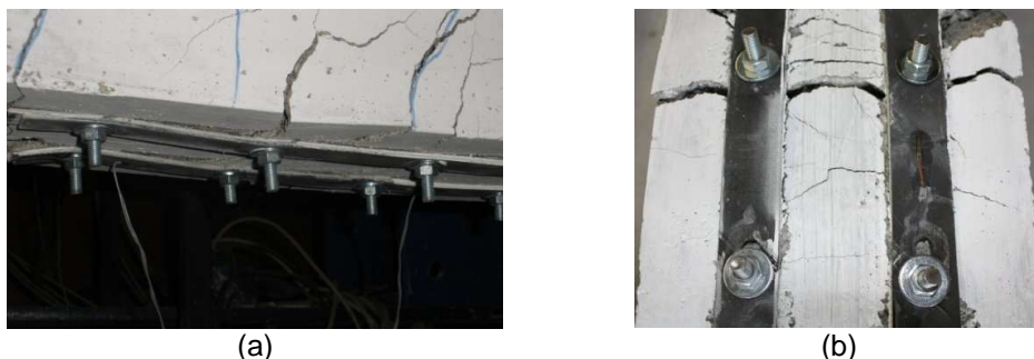
Figura 6 – Modo de rotura do laminado MDL-CFRP na viga MF-EBR: (a) deflexão vertical da viga; (b) pormenor do esmagamento do laminado.
